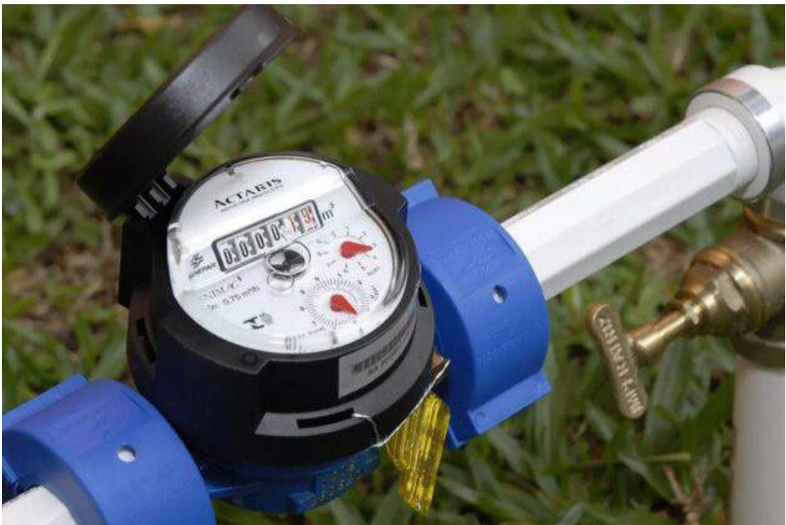
Hidrômetro instalado em residência
